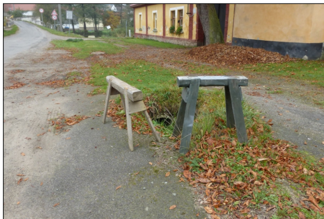
Propustek 28c - staničení 0,187 - propadlý
