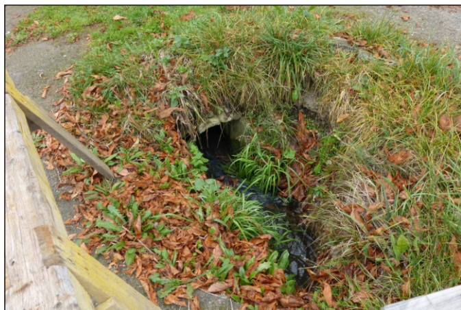
Propustek 28c - staničení 0,187 - propadlý
